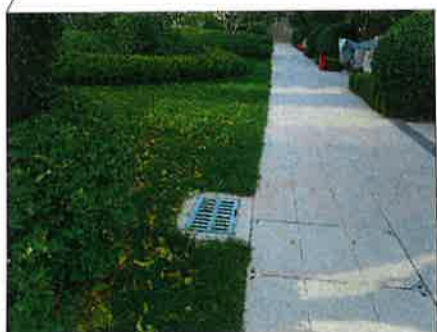
雨水管线雨篦子
