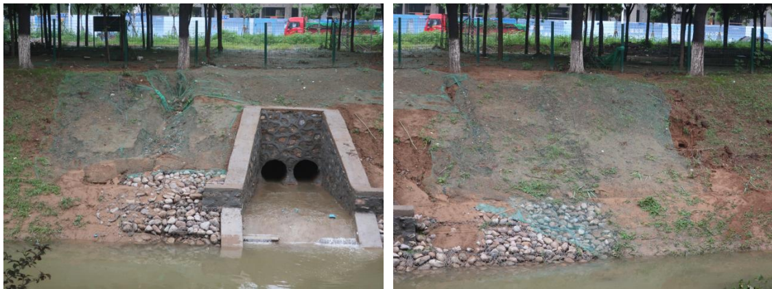
雨水口工程区出水口周边护坡被水流冲刷有侵蚀沟-2023.8
