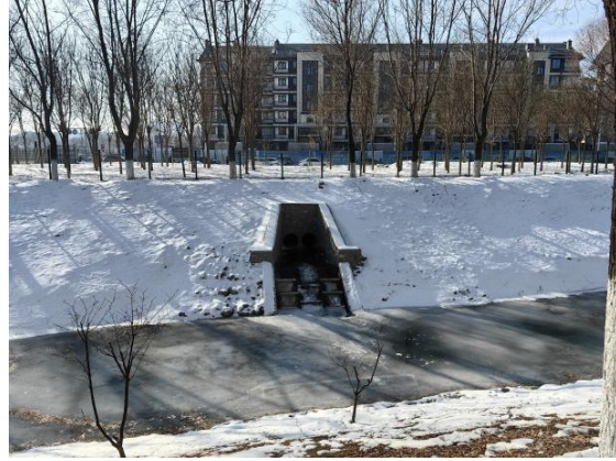
雨水口工程管线末端出水口-2023.12
