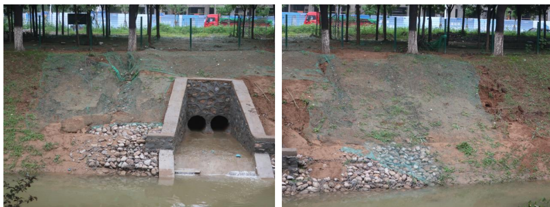
入河雨水口两侧护坡上侵蚀沟
